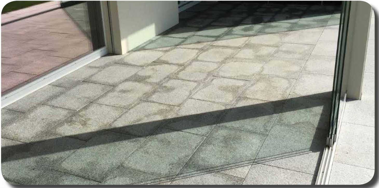
unästhetische Feuchtflecken / Hell-Dunkel-Erscheinung
